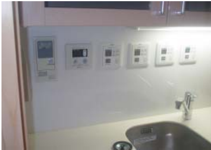
リモコン類は給湯室内に集中して設置
