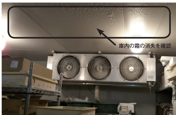
Fig. 3 TKSシステム稼働89日後の庫内写真
