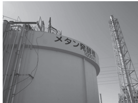
図1 メタン発酵槽
